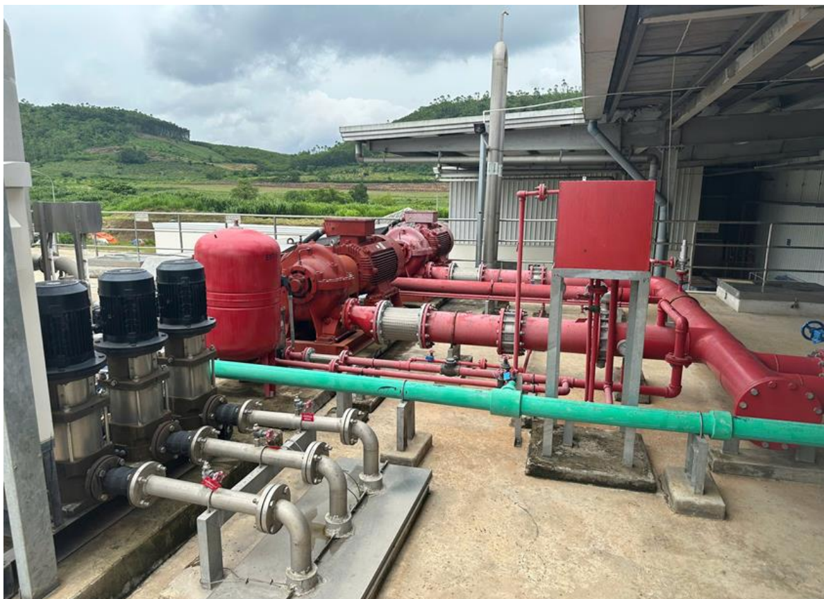
Hình 3. 11. Hệ thống PCCC tại cơ sở
