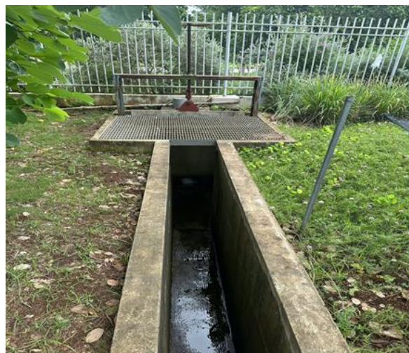
Cửa xả nước mưa số 02
