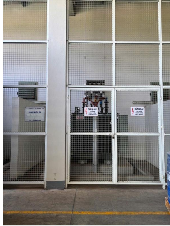
Máy biến áp
